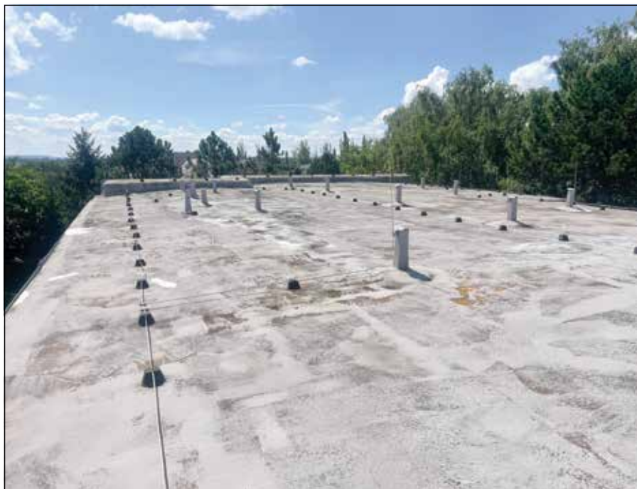
● Stav strechy materskej školy si vyžaduje modernizáciu
