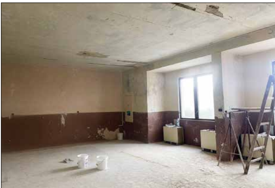
● Po oprave strechy je nevyhnutné sanovať v tomto roku i interiér požiarnej zbrojnice
