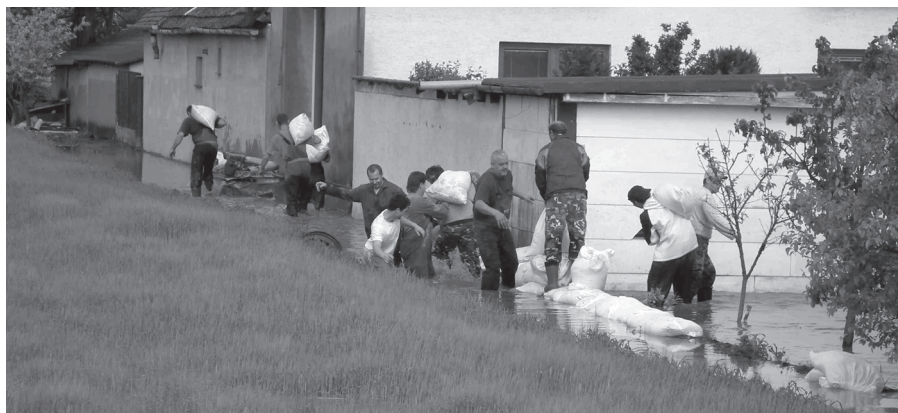
● Bariéry z vriec mali zabrániť ešte väčším škodám.
