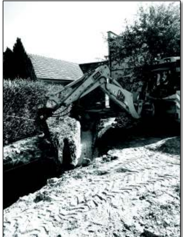
● Výstavba dažďovej kanalizácie ako jedného zo stavebných objektov rekonštrukcie domu služieb bola financovaná vďaka dotácii z environmentálneho fondu
